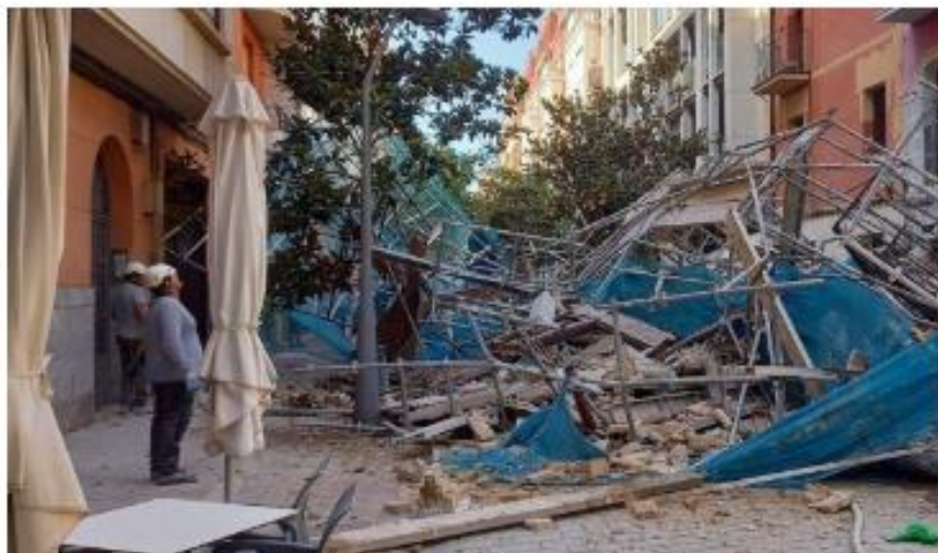
Derrumbe en la obra
